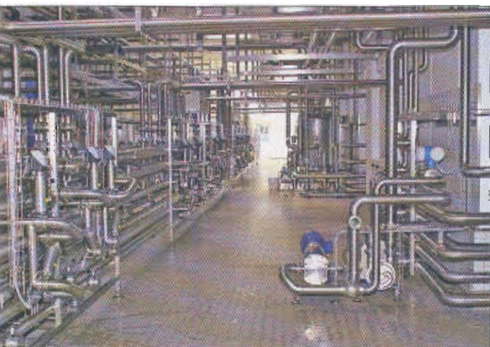
Im zentralen Bediengang befindet sich die Gasversorgung (CO 2 -Gewinnung, Abluftleitung, Sterilluft, CO 2 -Spanngas)
