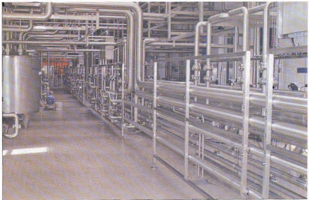
Zentraler Versorgungsgang für 50 ZKTs.
