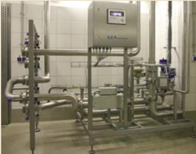
GEA-Diesel-Anlage zur exakten Speisedosage
