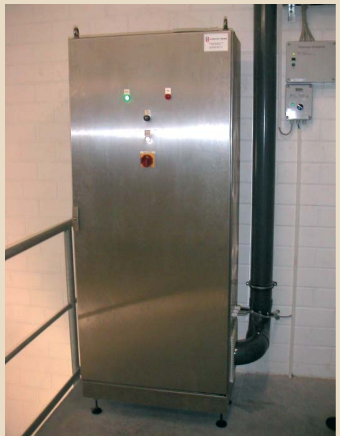
Abb. 4 Ionisationsanlage im Treppenhaus
