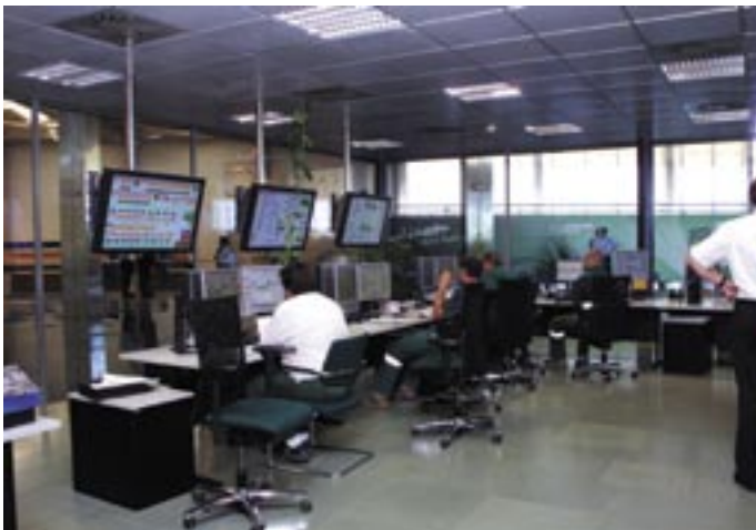
Leitzentrale der Cruzcampo-Brauerei
