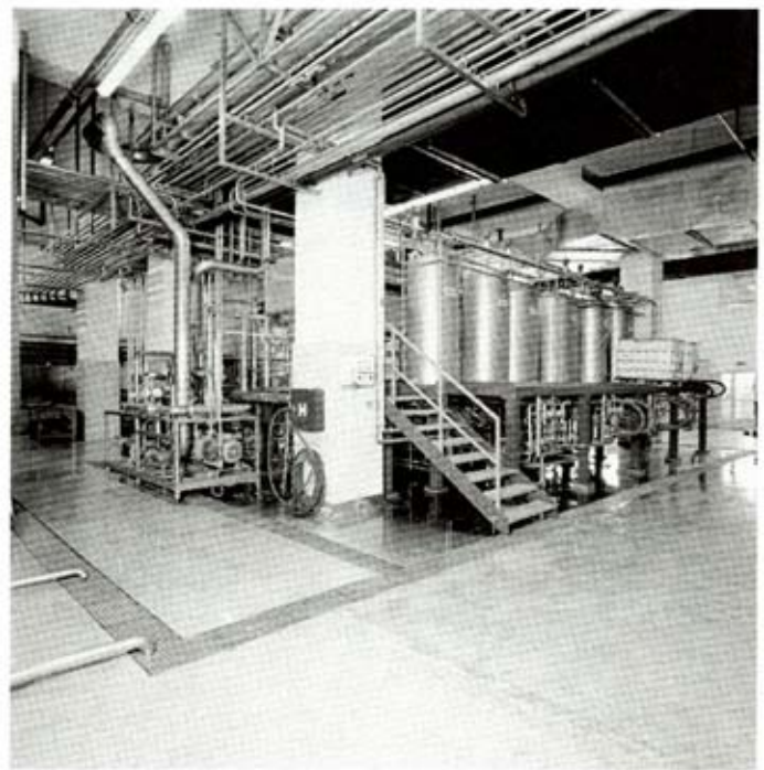
Abb. 3 Wasserentgasung conti Stream DA 2000, Lösestation für Trockenteile, Station für flüssige Limonadengrundstoffe
