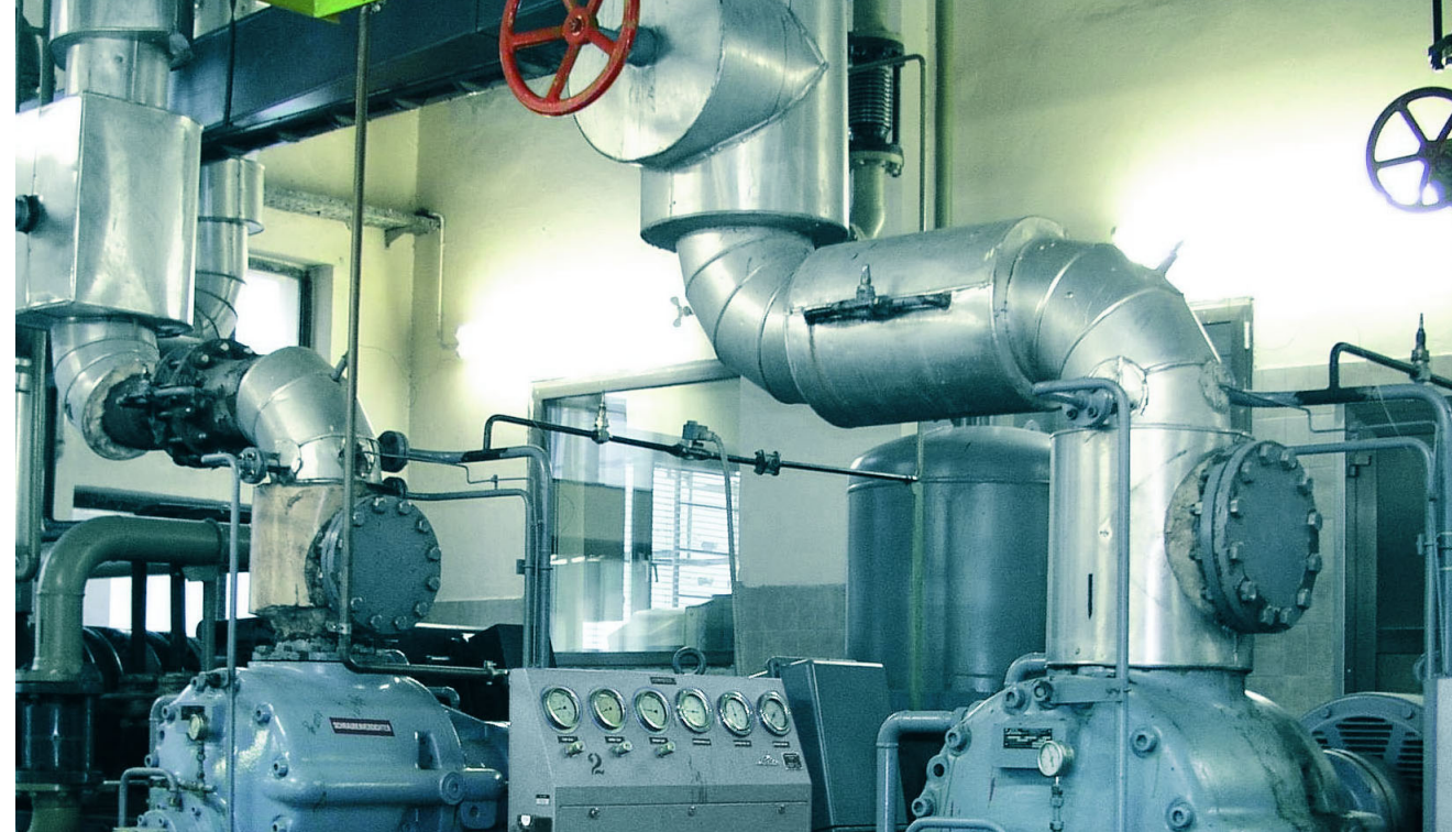
Die Kompressoren der bestehenden Anlagen wurden weiterverwendet.
