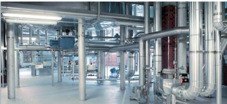
Aufgeräumt – die Technik-Ebene des Sudhauses
