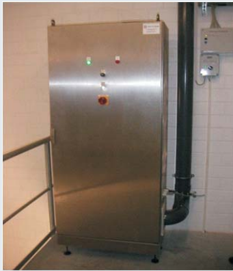
Abb. 4: Ionisationsanlage im Treppenhaus
