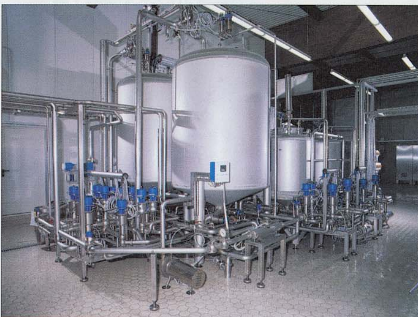
Ventilblock vor dem Lösebehälter.
