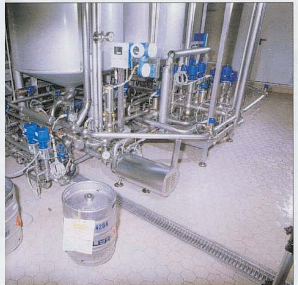
Ventilblock hinter dem Mischbehälter.
