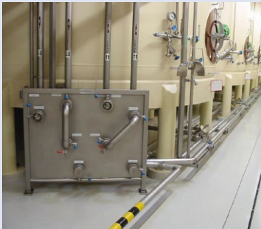
Verrohrungssystem mit festinstallierten Umschaltpaneelen.
