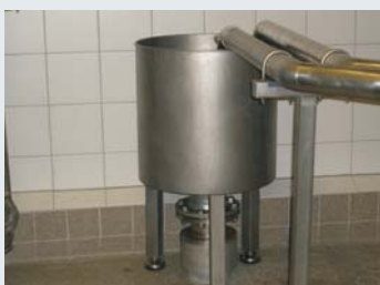
Die Gullykonstruktion mit Desinfektionsmittelvorlage sorgt für eine wirksame Kontaminationssperre.
