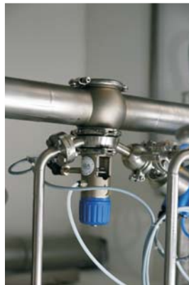
In der Konstruktion bei Schneider ist die Reinigung und Sterilisation in die Verrohrung integriert.
