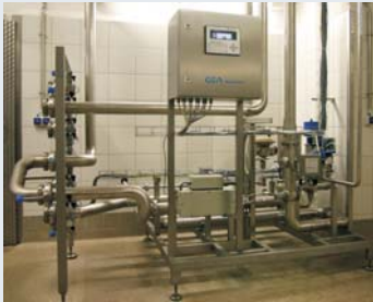
GEA Diesel Anlage zur exakten Speisedosage
